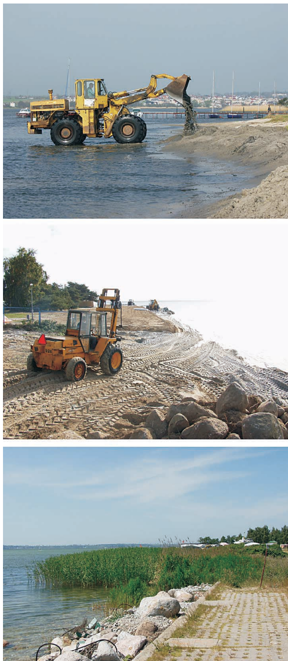
Fot. 2. Przykład fizycznej destrukcji naturalnego siedliska. Trzebieenie i zasypywanie pasa roślinności przybrzeżnej oraz budowa betonowo-kamiennych umocnień na odzatkowym brzegu Półwyspu Helskiego fragmentuje lub unicestwia linearny układ wzdłużbrzeżnego ekotonu, tworząc całkowicie obcy temu miejscu biotop (fot. arch. SMIOUG)
